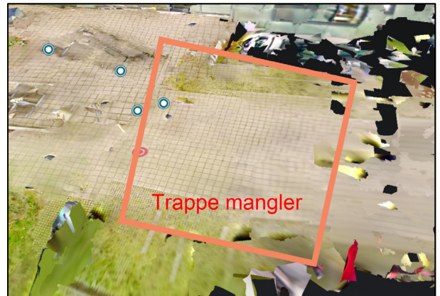
Billede 6: Trappe mangler ved niveauspring
